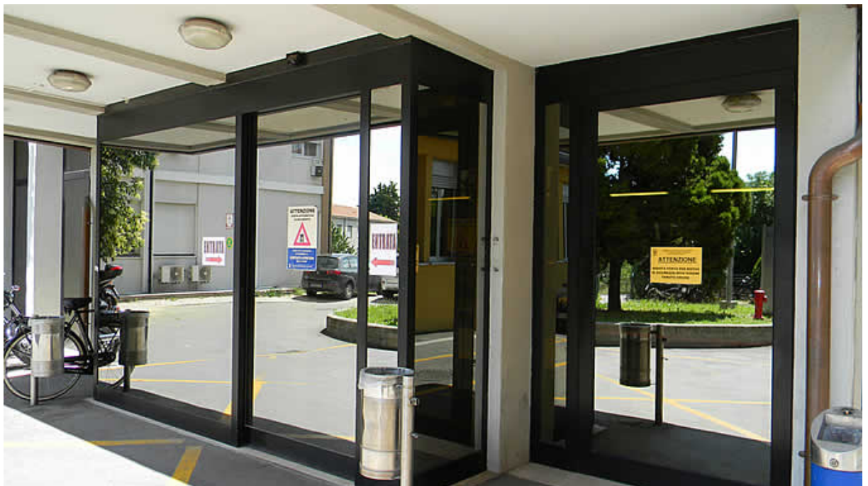
La arquitectura debe también ser comunicación, al menos en la sección de Neurología de un hospital. Aquí la puerta es tan difícil de detectar que los empleados han tenido que agregar señales para identificarla.
